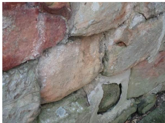
Auswaschungen im Sockelbereich
