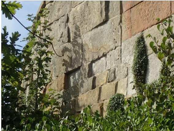
Verformung im Detail
