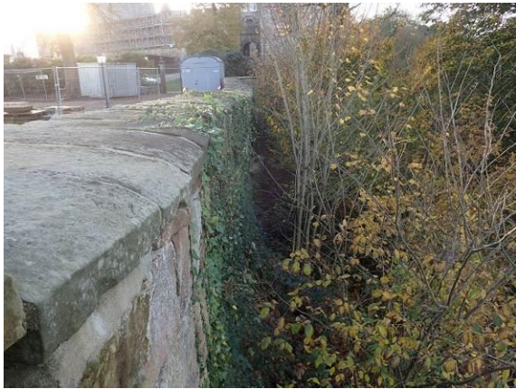
Bewuchs untere Wehrmauer, Nordwand
