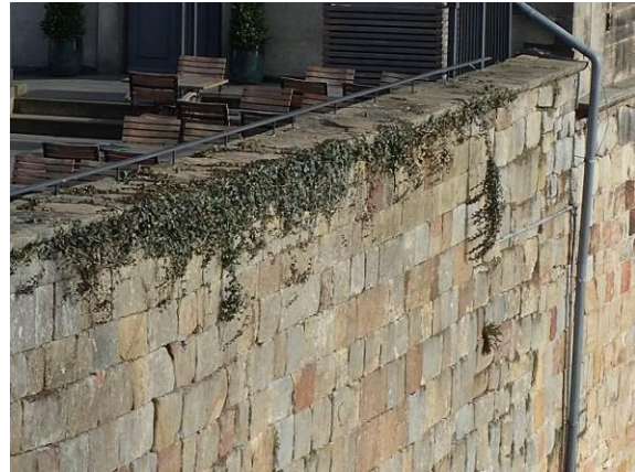
Efeubewuchs unterhalb der Mauerabdeckung
