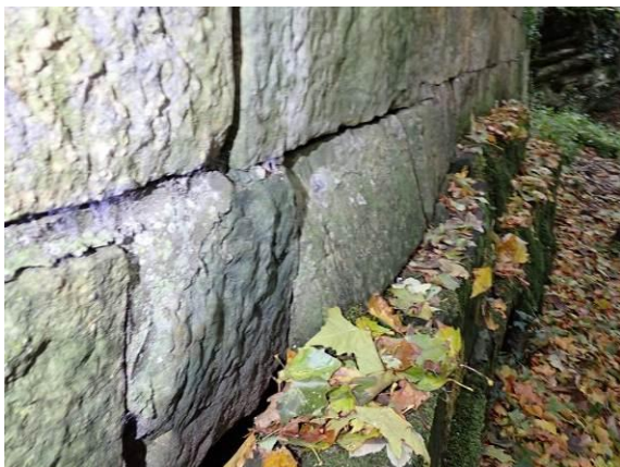
Fugenschäden an der Nordoberfläche
