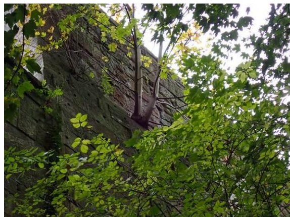
Baumbewuchs im Fugennetz, Nordmauer
