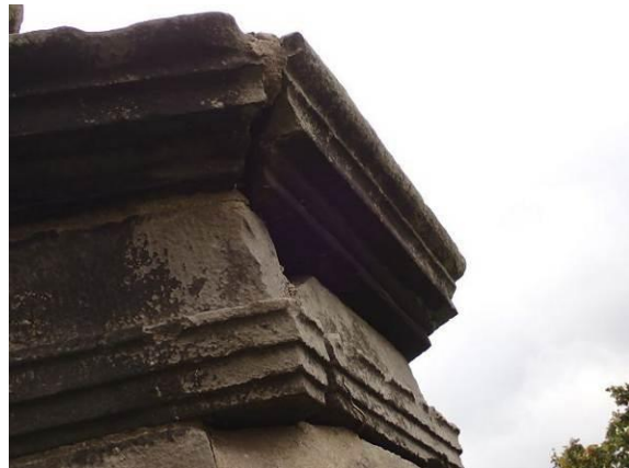
Schädigung im Kapitellring
