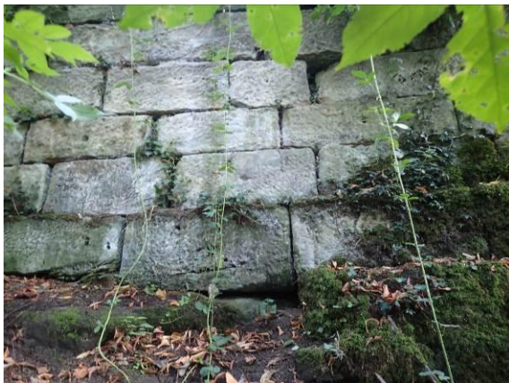
Schädigung am Wandfuß
