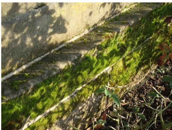
Moosbewuchs auf dem Sockelmauerwerk
