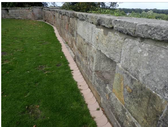
Schiefstellung der Gesamtwand
