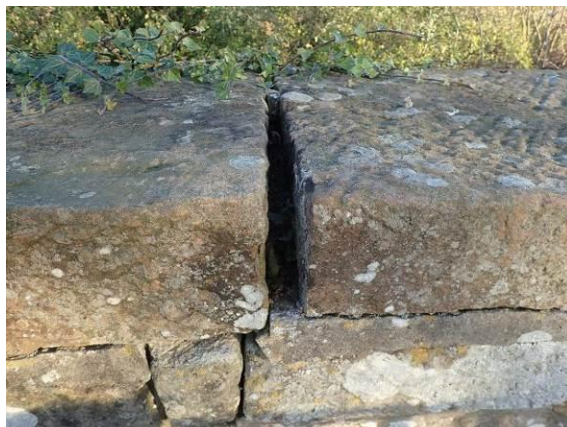
Zustand der Verfugung
