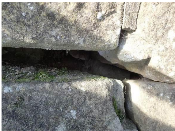
Gefügeschaden im Detail
