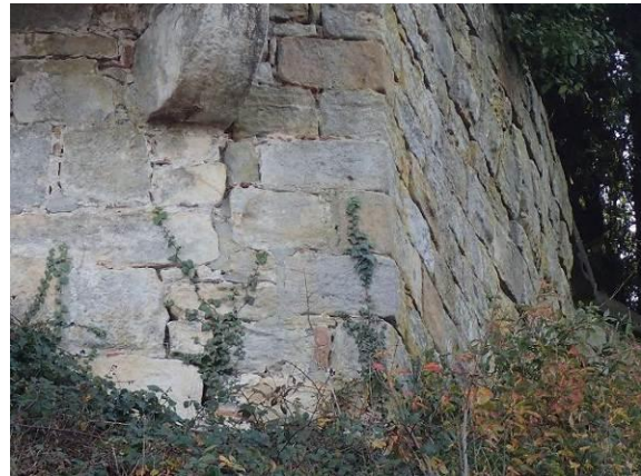
Baufuge an den Kragsteinen
