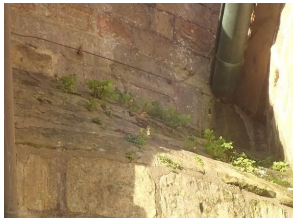
Bewuchs in den Fugen des Steindaches
