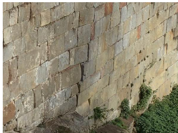
Verformung im Detail
