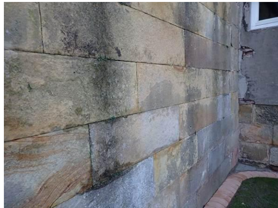
Wasserführung über die Steinoberflächen
