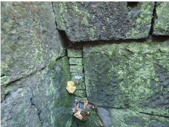
Gefügeschaden am Halsmauerwerk
