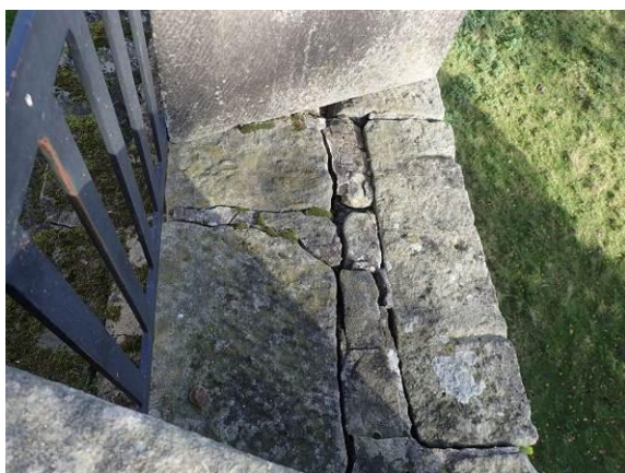
Geschädigte Verfugung in einer Scharte
