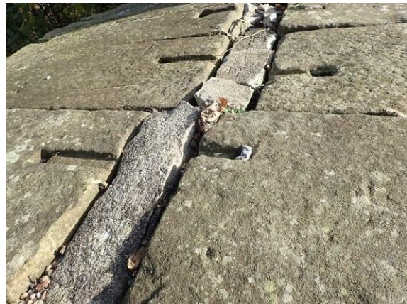
Verformung des Plattenbelags
