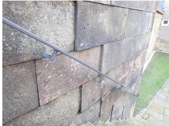
Verformung im Detail
