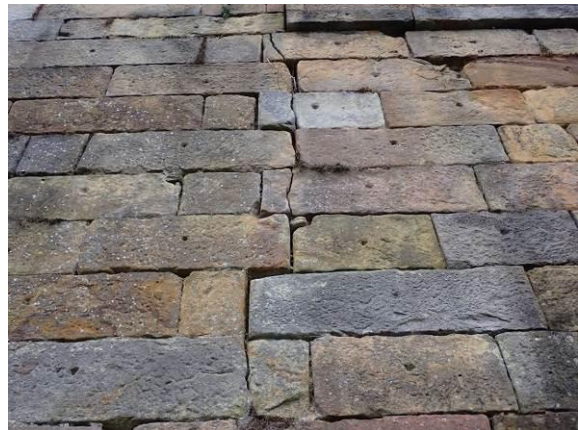
Rissbildung an einer Baufuge
