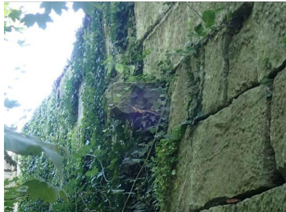
Bewuchs im Detail
