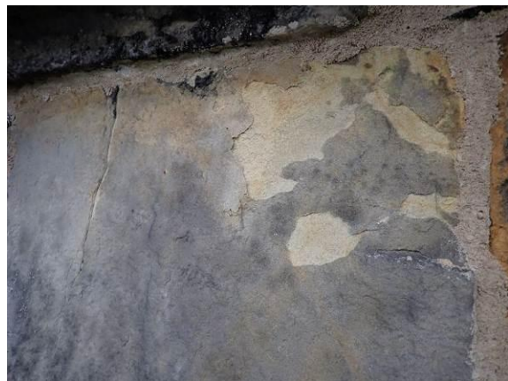
Oberflächenverlust durch Dampfdruck
