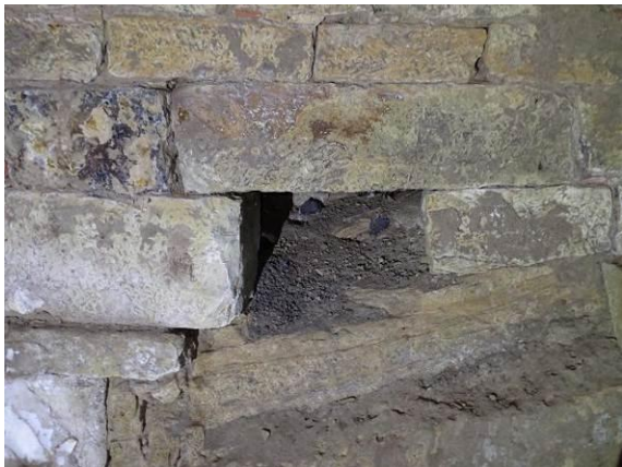
Verformung im Detail
