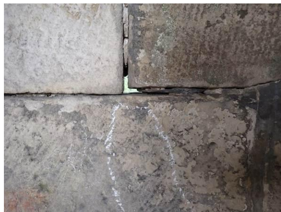
Schädigung der Verfugung
