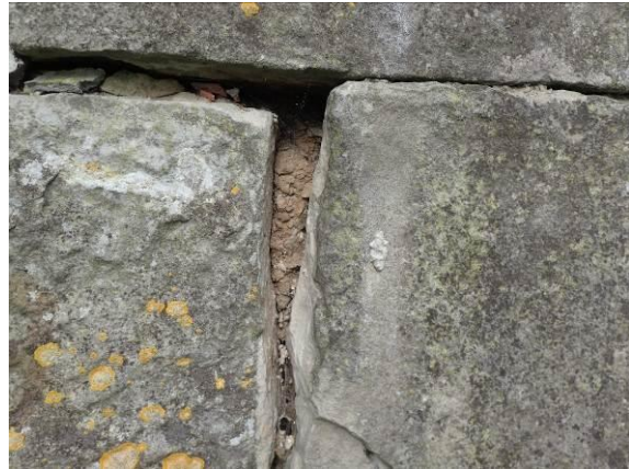
Gefügeschaden Mauerkrone im Detail
