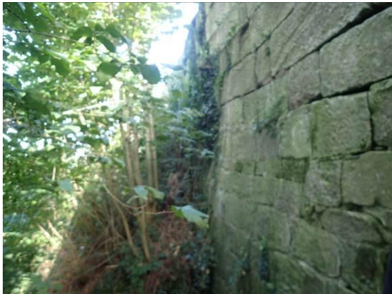
Gefügeschaden am Stützwandanschluss
