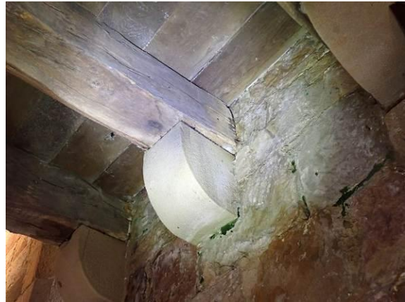
Biogener Bewuchs im Detail
