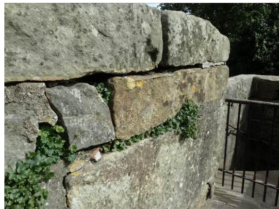
Gefügeschaden an der Mauerkrone
