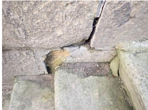
Steinschaden im Detail
