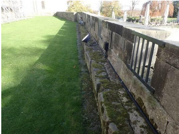
Mauerwerksversprung der Ostwand
