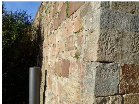
Gefügeschaden westlich der Treppenpavillons
