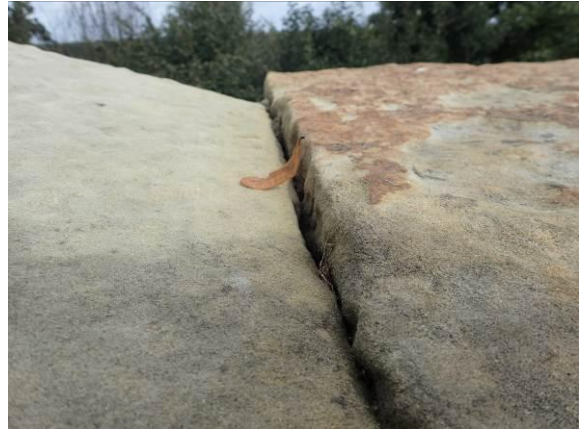
Verformung im Detail
