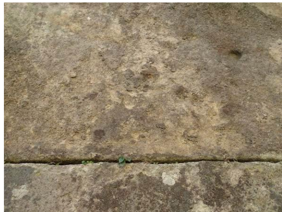
Oberflächenverlust im Detail
