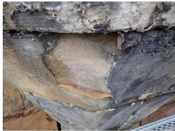
Abplatzung im Detail
