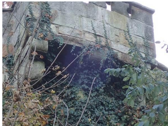
Zustand am Erker Nord
