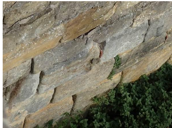
Verstärkte Steinschäden am Wandfuß
