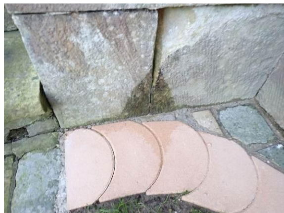
Austretendes Schichtenwasser im Fugenbereich
