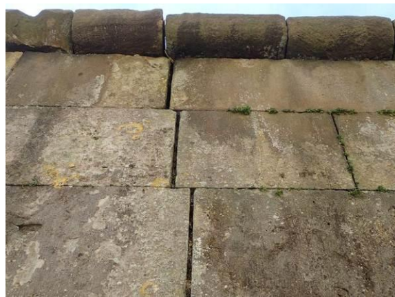
Rissbildung im oberen Wandbereich
