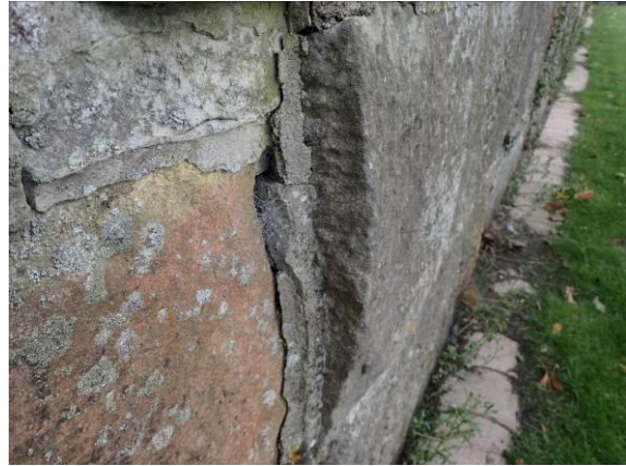
Verformung im Detail
