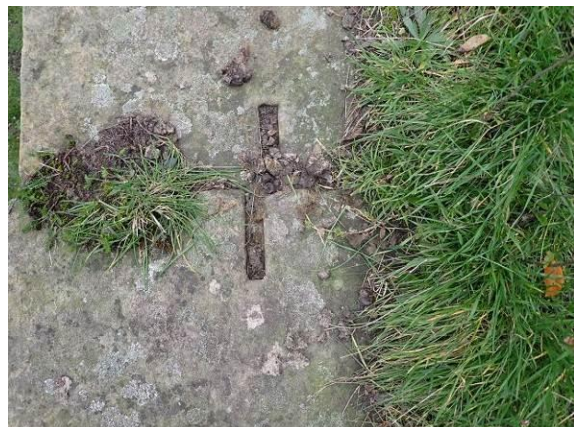
Detail, geschädigte Verklammerung
