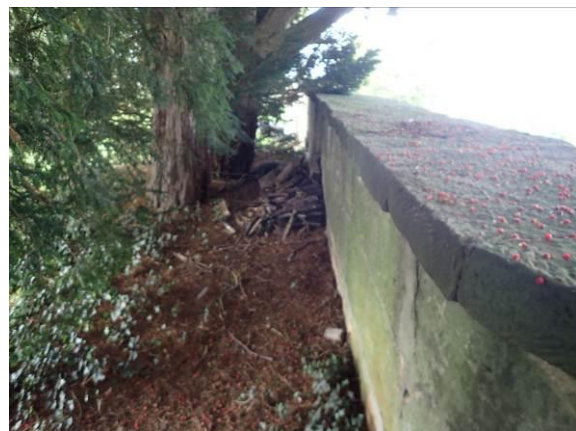
Verformung der Mauerkrone
