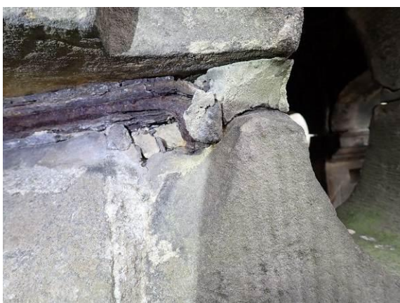
Korrodierte Klammer im Detail
