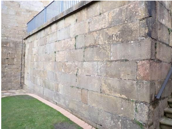
Ansicht verformte Westwand
