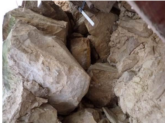
Gefügeschaden im Übergang zum Kernmauerwerk
