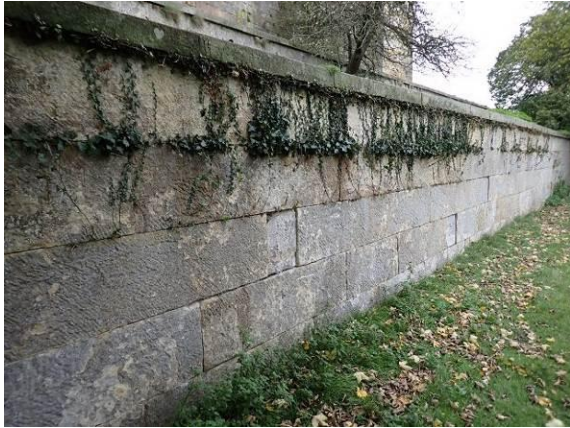
Efeu Bewuchs südliche Terrassenwand
