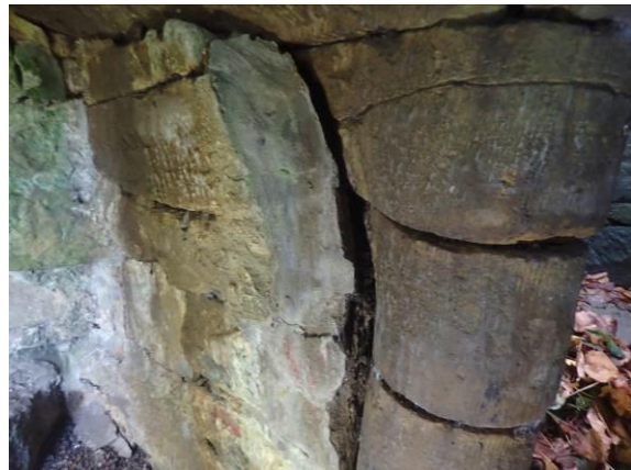
Abgängige Stirnwand am unteren Treppenlauf
