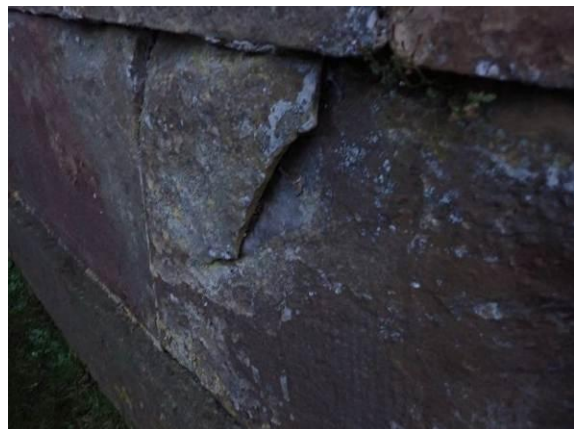
Kantenausbrüche nach Verformung
