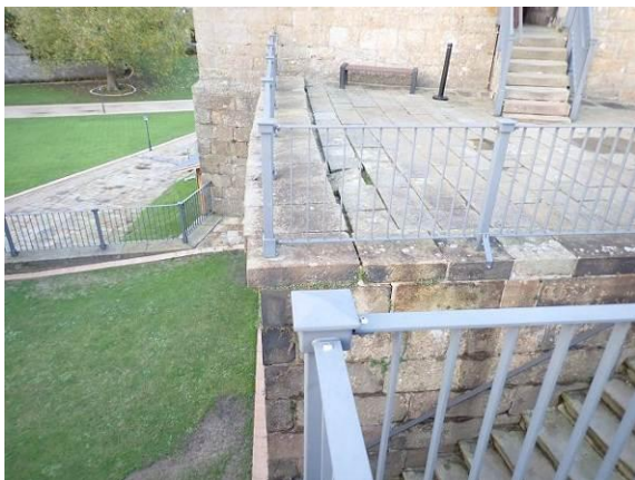
Verformte westliche Terrassenwand
