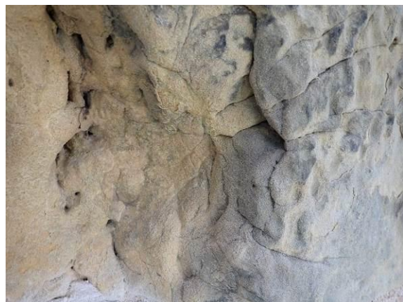
Gefügeschaden im Detail
