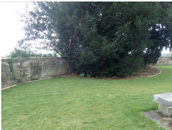
Baumbewuchs an der Wehrmauer
