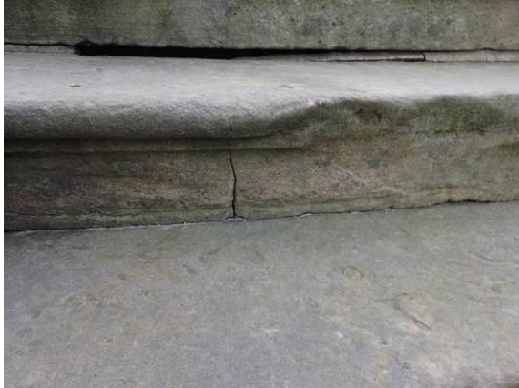
Rissbildung in einer Blockstufe
