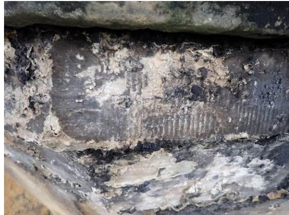
Zustand an der Anlagerungskrusten im Detail
