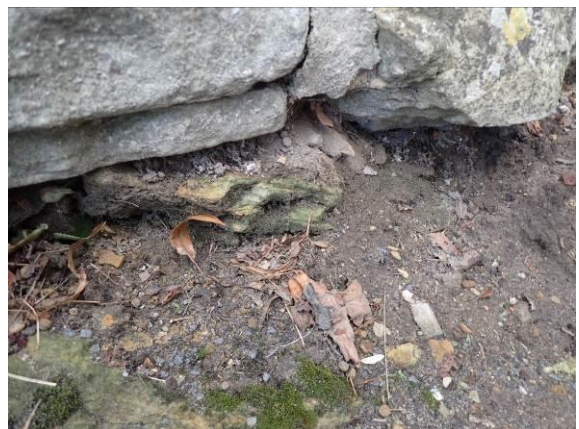
Gefügeschaden am Fundamentaufstand
