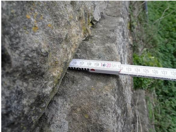
Auswaschungen im Kernmauerwerk
