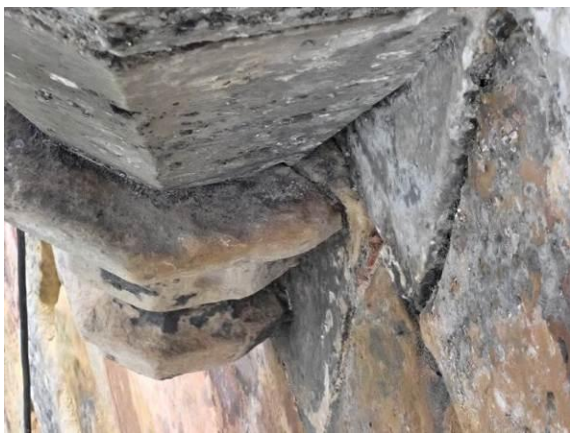
Rissbildung am unteren Kragstein
