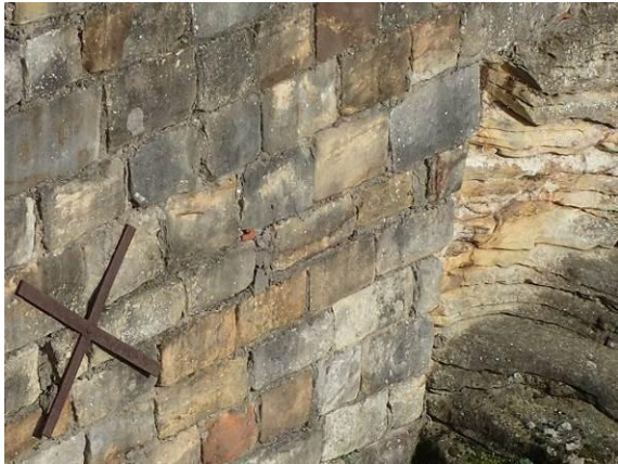
Verformung im Anschluss zum Felsen
