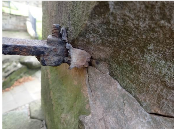
Korrosionssprengung am Naturstein
