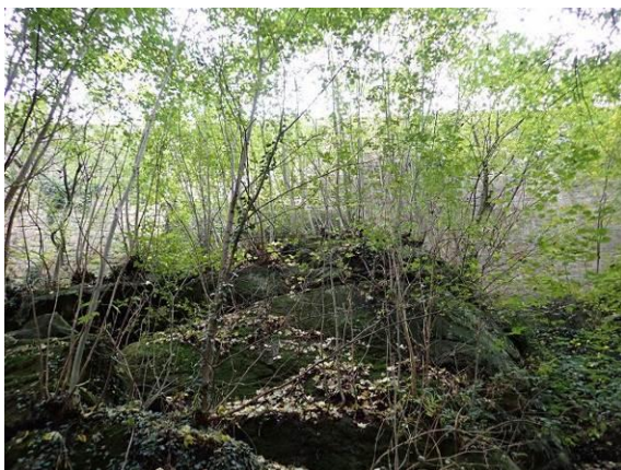
Bewuchs an der oberen nördlichen Wehrmauer
