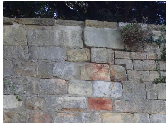
Gefügeschaden an der Mauerkrone
