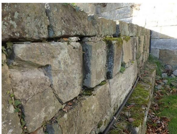
Gefügeschaden im Detail
