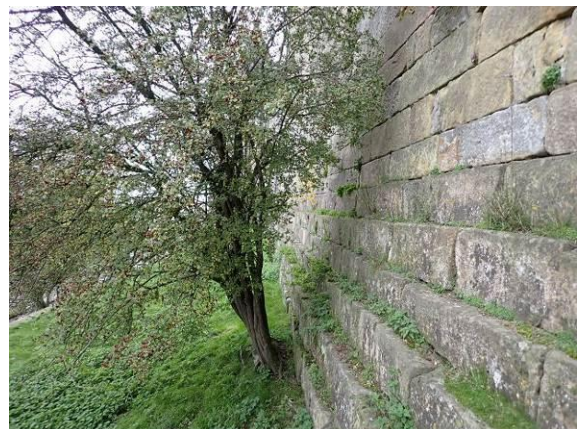
Baum an der Südwand
