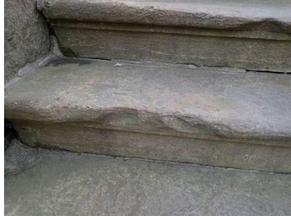
Ausbrüche an den Blockstufen
