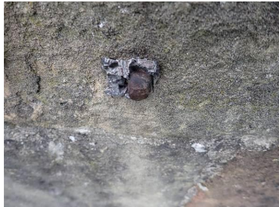
Ehemalige Verankerung mit geschädigter Einbleiung
