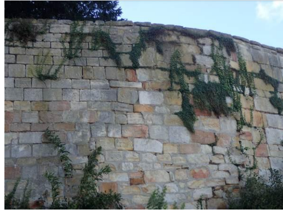
Pflanzenbewuchs im Fugennetz
