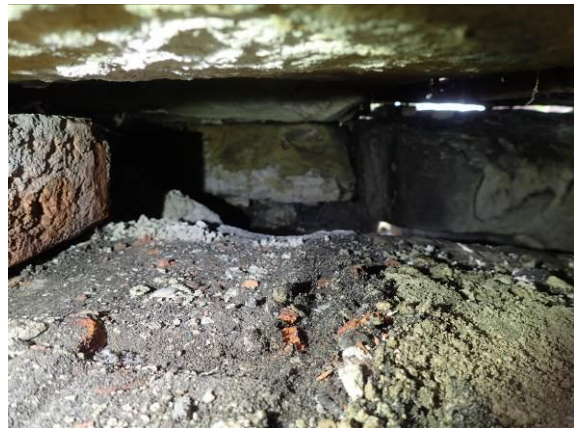
Zustand unterhalb der Abdeckung
