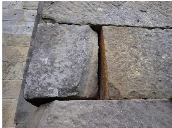
Gefügeschaden im Detail
