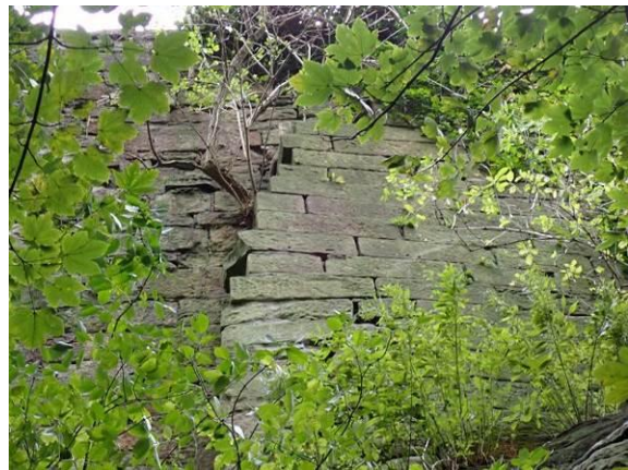
Gefügeschaden an einer Vorsatzschale
