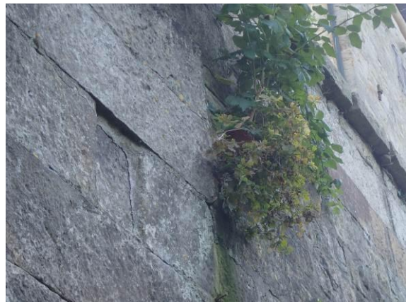
Bewuchs in der Anschlussfuge
