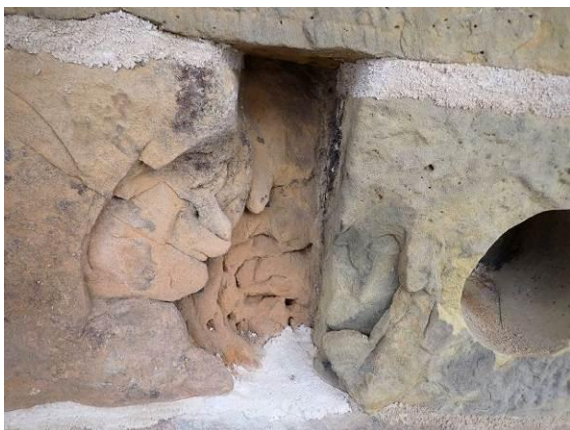
Mechanische Schädigung Ostoberfläche
