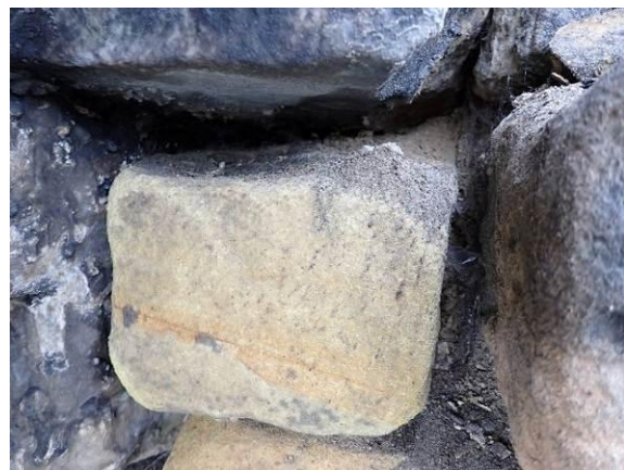
Gefügeschaden unterhalb der Kragsteine
