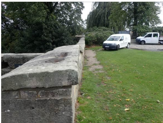
Verformung der Mauerkrone
