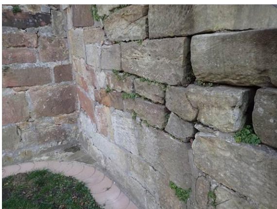
Verformung der Wangenwand
