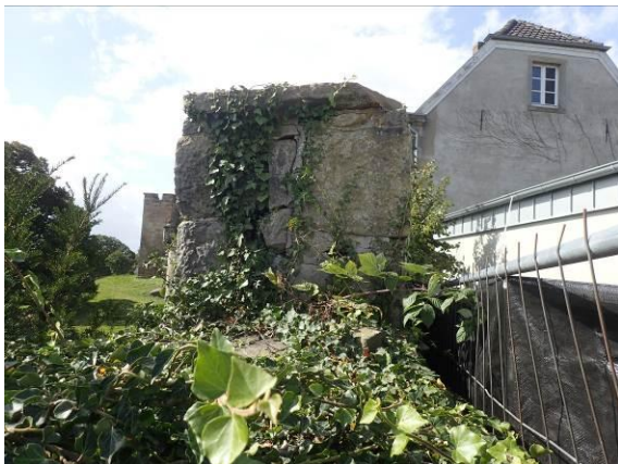
Bewuchs im Westlichen Wandbereich
