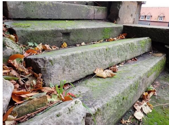
Verformung im Detail
