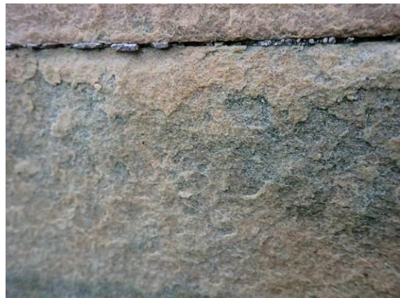
Zustand einer Pressfuge
