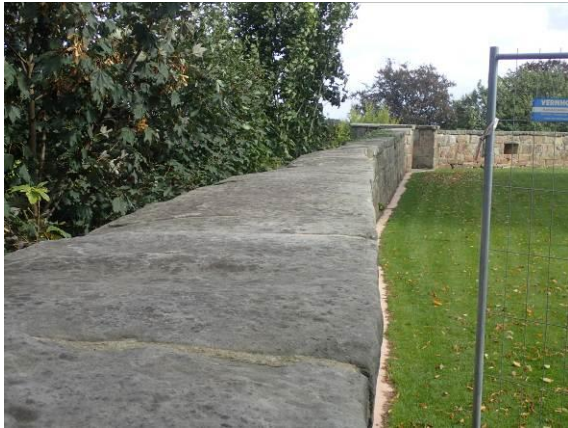
Verformung Mauerkrone des Untersuchungsbereichs
