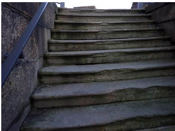
Schädigung der Profilkanten
