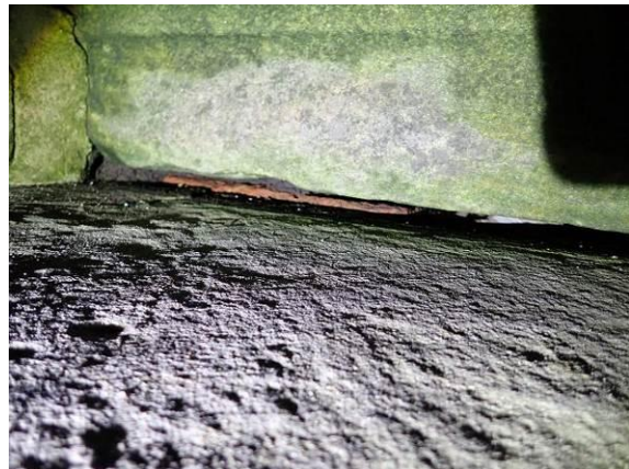
Geschädigte Auffüllung unter einer Blockstufe
