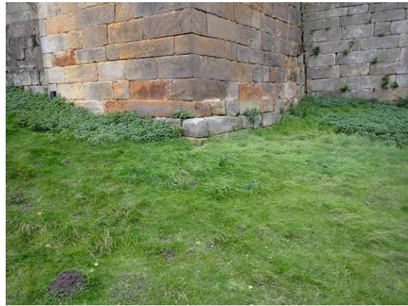
Steinschäden in den unteren Wandbereichen
