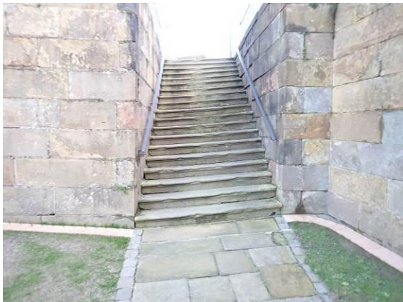
Verformte Freitreppe zum oberen Platon
