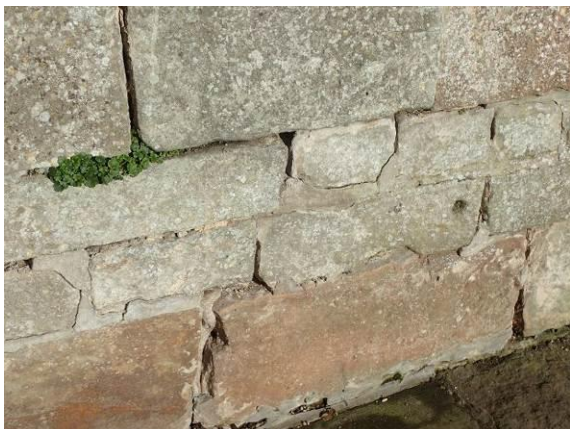
Gefügeschaden östlich des Treppenpavillons
