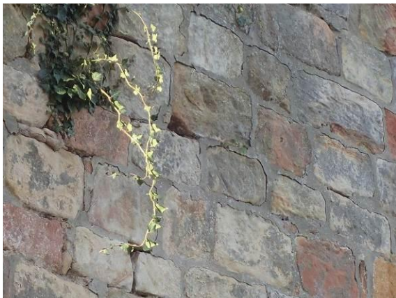
Verformungsbild durch Ablösung von Reparaturfugen
