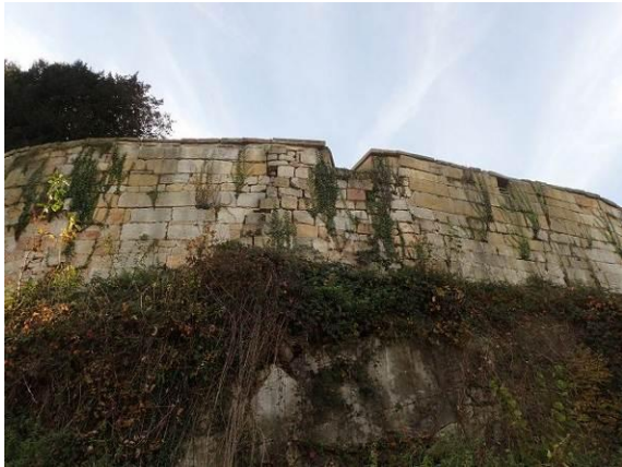
Gefügeschaden an einer Eckausbildung
