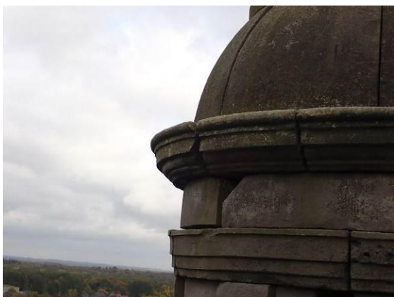
Verformung im oberen Gesimsring
