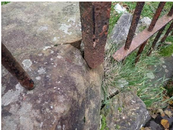
Fehlende Verbindung zum Sockel
