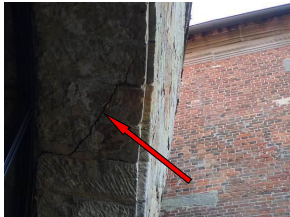
Rissbildung durch Schalenseparation
