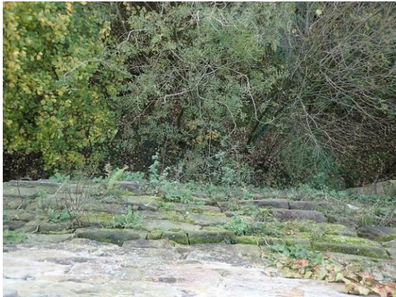
Bewuchs im Fugenbereich, Nordwand
