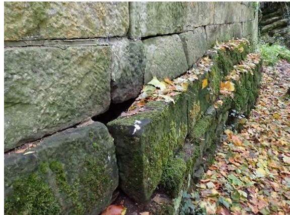
Gefügeschaden im Detail
