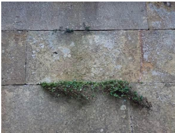
Bewuchs im Fugenbereich
