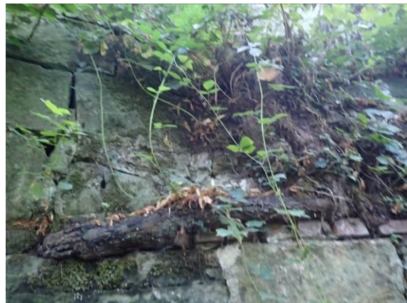
Gefügeschaden durch Wurzeldruck
