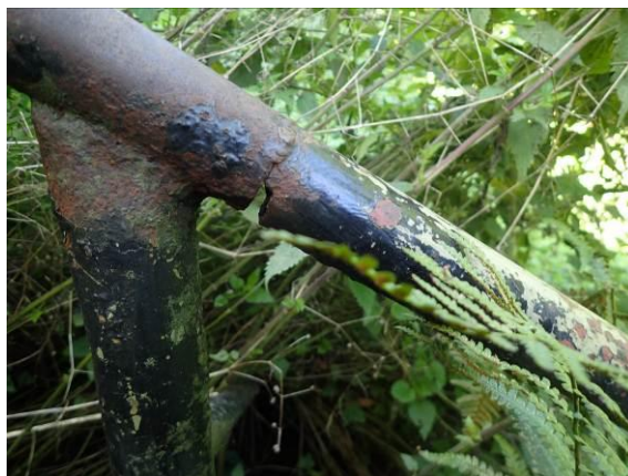
Korrosionsschaden im Detail
