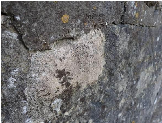
Oberflächenverlust im Detail
