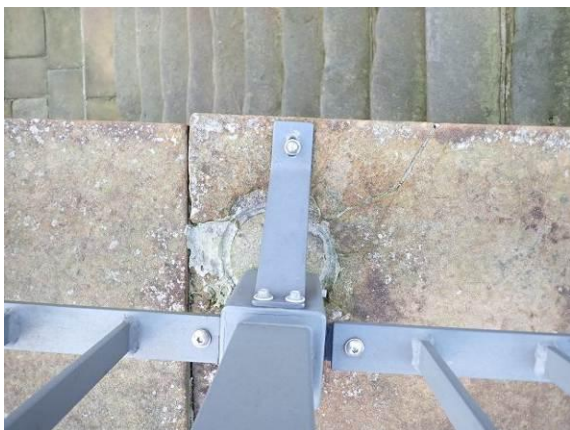
Verformung der Mauerkrone, Plattenstoß
