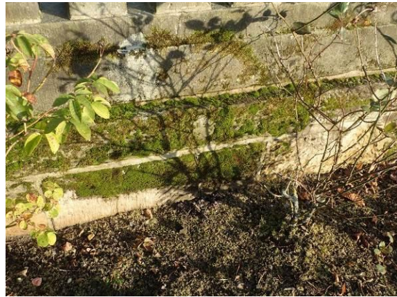
Moosbewuchs am Sockelmauerwerk
