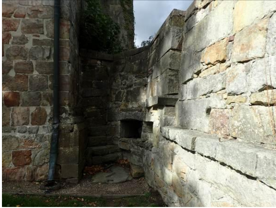
Schiefstellung der Mauerkrone
