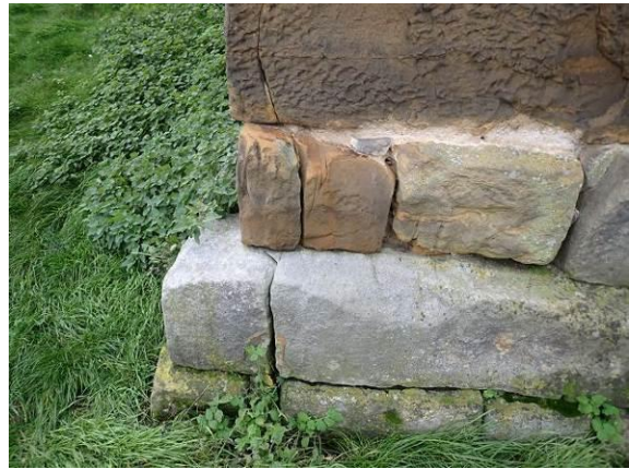
Gefügeschaden im Fundamentmauerwerk
