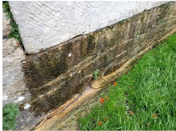
Wasserführung auf dem Felsen
