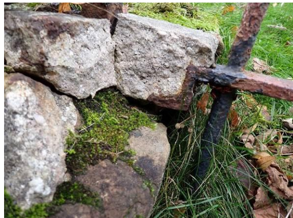
Korrosionssprengung im Detail
