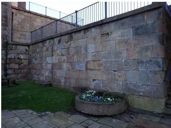
Verformte untere Nordwand
