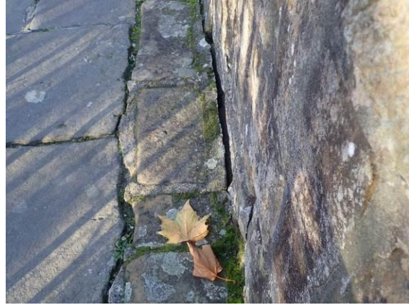
Zustand der überformten Wehrgangabdeckung
