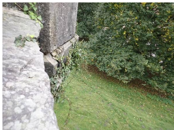
Schädigung am Basisring
