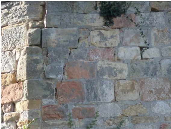
Gefügeschaden an einer Eckausbildung
