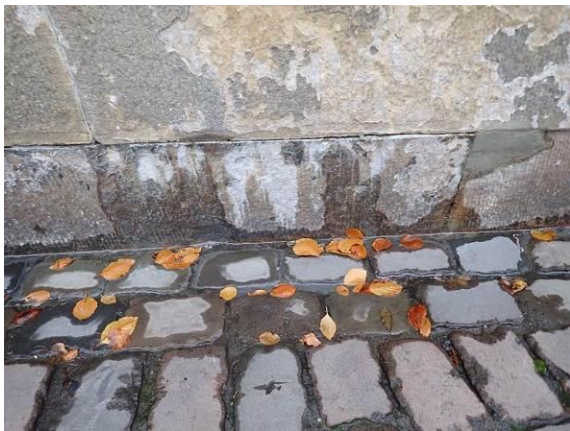
Wasserdurchfluss aus den Lagerfugen
