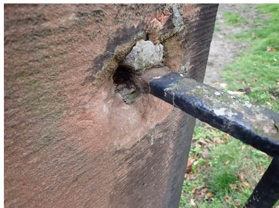
Schädigung der Horizontalbänder
