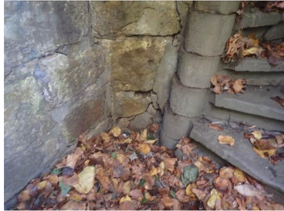
Verformte Spindel im Antrittsbereich
