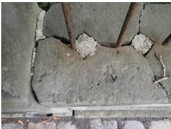
Korrosionssprengung am Brüstungsgurt
