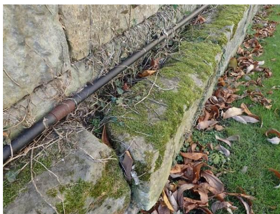
Gefügeschaden am inneren Mauervorsprung
