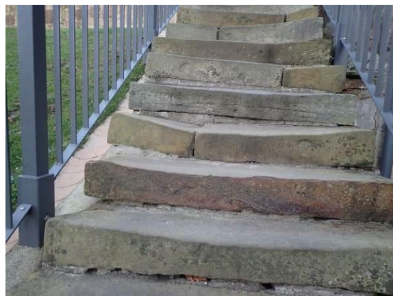
Verformung des Stufenbelags
