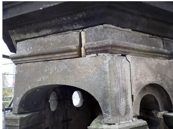
Gefügeschaden im Kapitellring
