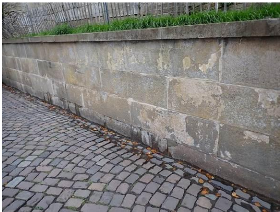
Schädigungen an der unteren Terrassenstufe
