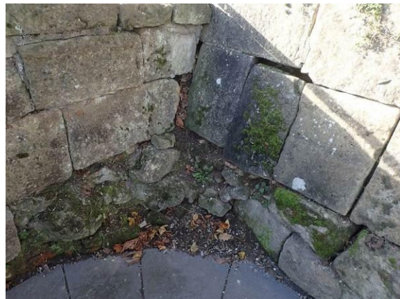
Schalenversagen der Zwingerwand
