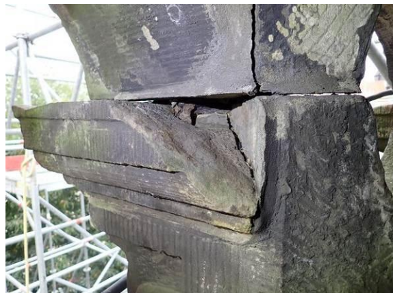
Steinausbruch durch Korrosionssprengungen
