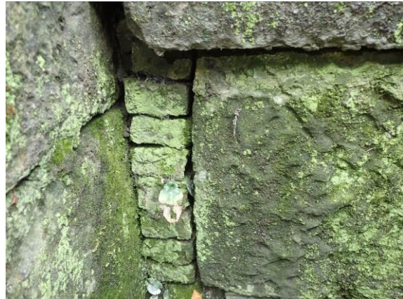
Gefügeschaden am Wandanschluss Treppenhaus
