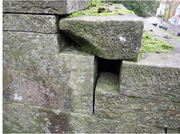
Geschädigte Auflagerungen auf den Wangen
