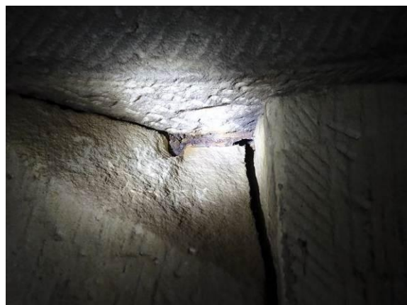
Geschädigte Verklammerung im Detail
