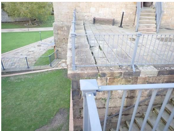
Verformung Terrassenwand West
